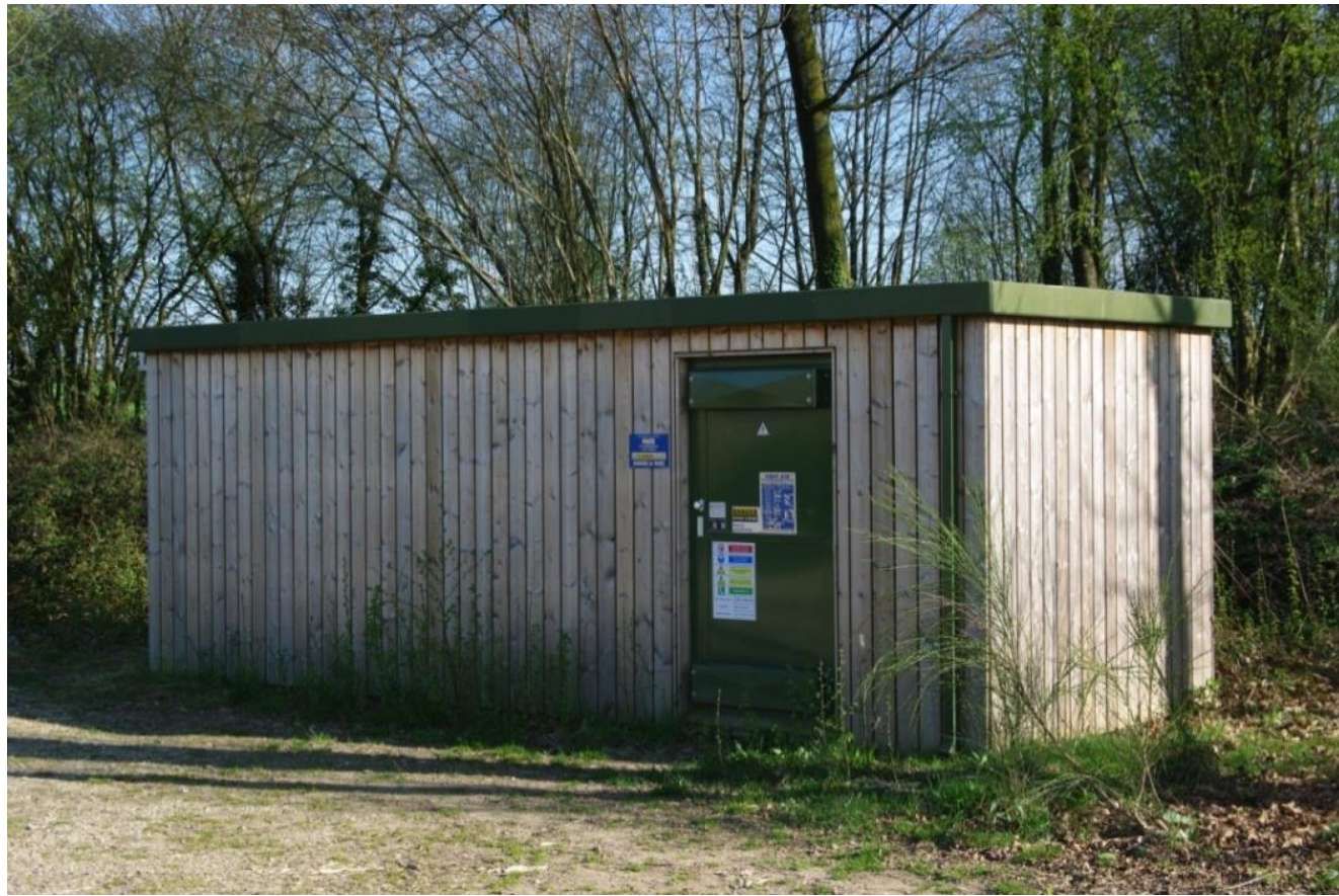
Photo 3 : Poste de livraison standard
